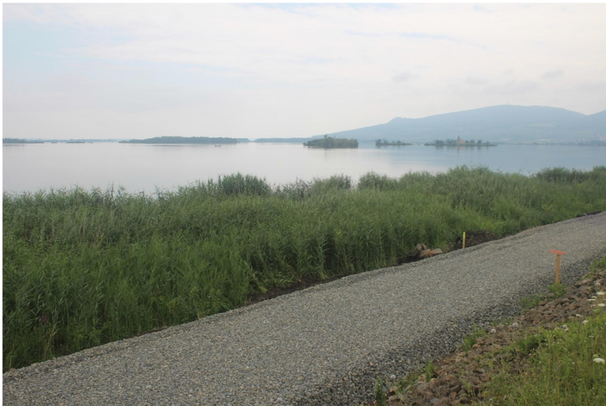
Obr. B.I.4.1: Výstavba cyklostezky na patě hráze horní nádrže, pohled na ostrovy ve střední nádrži
