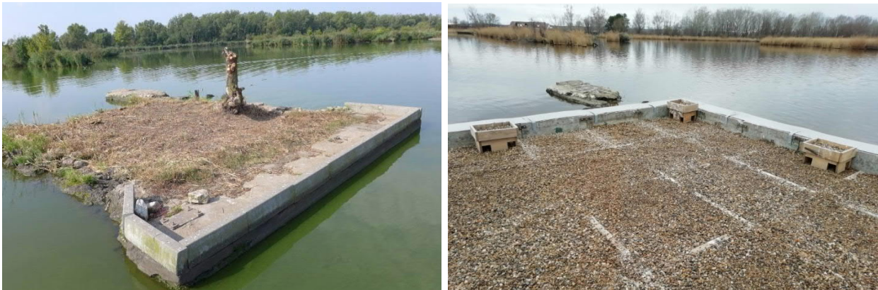
Obr.B.I.6.2: Nájezdová rampa (pilíř I), stav v roce 2019 (vlevo) a stav v roce 2020 (vpravo). (HG partner s.r.o., 2019, Povodí Moravy s.p., 2020)
