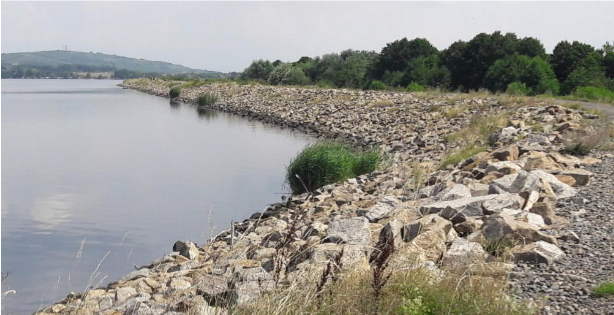
Obr. D.I.15: Úsek dolní nádrže JV od Pavlova stabilizovaný kamenným záhozem boční hráze.
